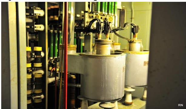
Modulator racken. Rören på isolatorer.
