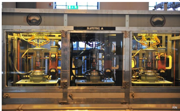
En av två slutsteg med Marconirör.
