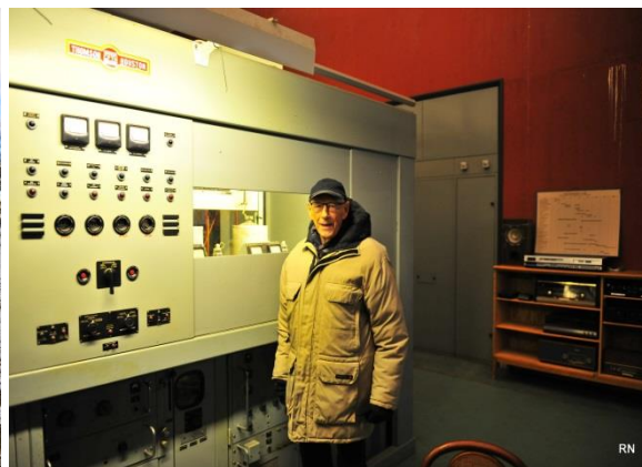
Sändarhallen med kontrollpanel
